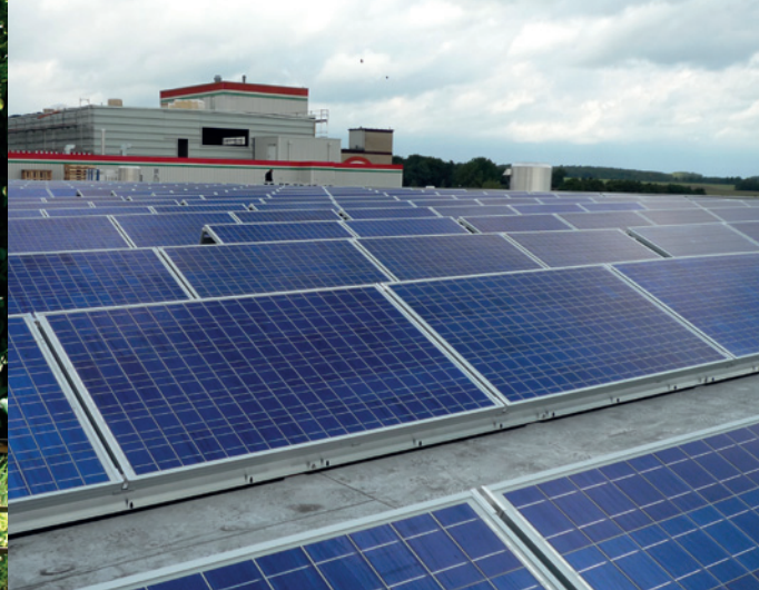
Własna instalacja fotowoltaiczna produkuje 180.000 kWh energii elektrycznej rocznie.
